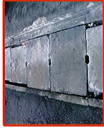
Tutup Bukaannya atau Lubang, Longkang, Laluan Paip Air, Sekitar Tapak Bangunan dengan Menggunakan Jaring Besi atau Simen
