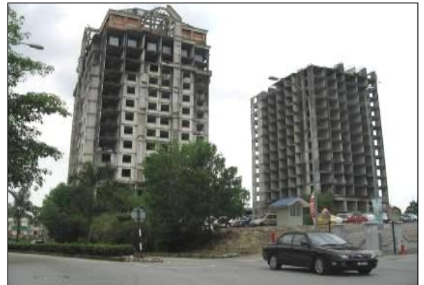
Foto 39: Projek pembinaan hotel terbengkalai di Jalan Toman 2, Seremban, (Mac 2007).
